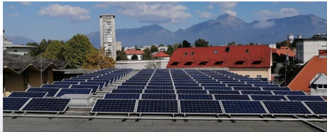
Sončna elektrarna na strehi upravne stavbe MOK
