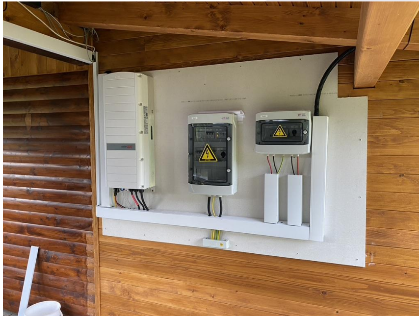
Inverter Solar Edge - RWS
